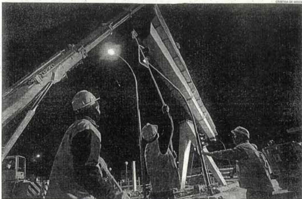
Un momento de las obras ejecutadas anoche en la avenida de Dénia para desmontar la pasarela situada frente al colegio de los Jesuitas
