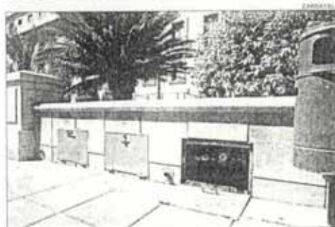
Puerta rota en el lugar donde se encuentran los contadores del Principal
