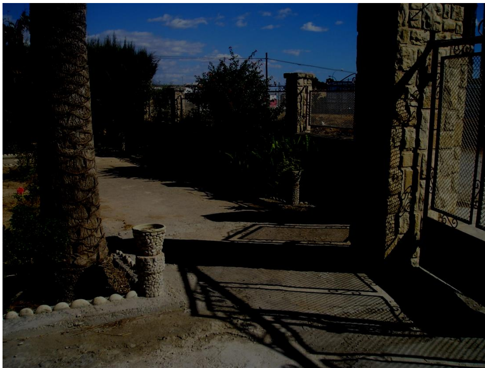
Foto 4.- Vista zona afectada interior de parcela.
